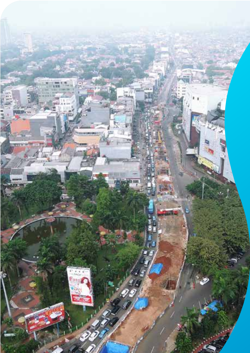
≡ Foto aerial konstruksi layang di kawasan Blok M, 19 Mei 2015. Dok. PT MRT Jakarta.
